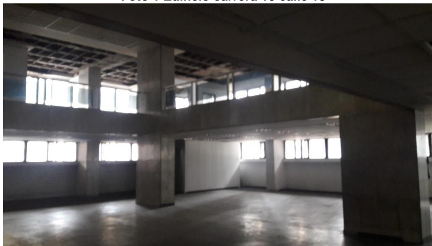
Foto 2 Edificio carrera 10 calle 18
