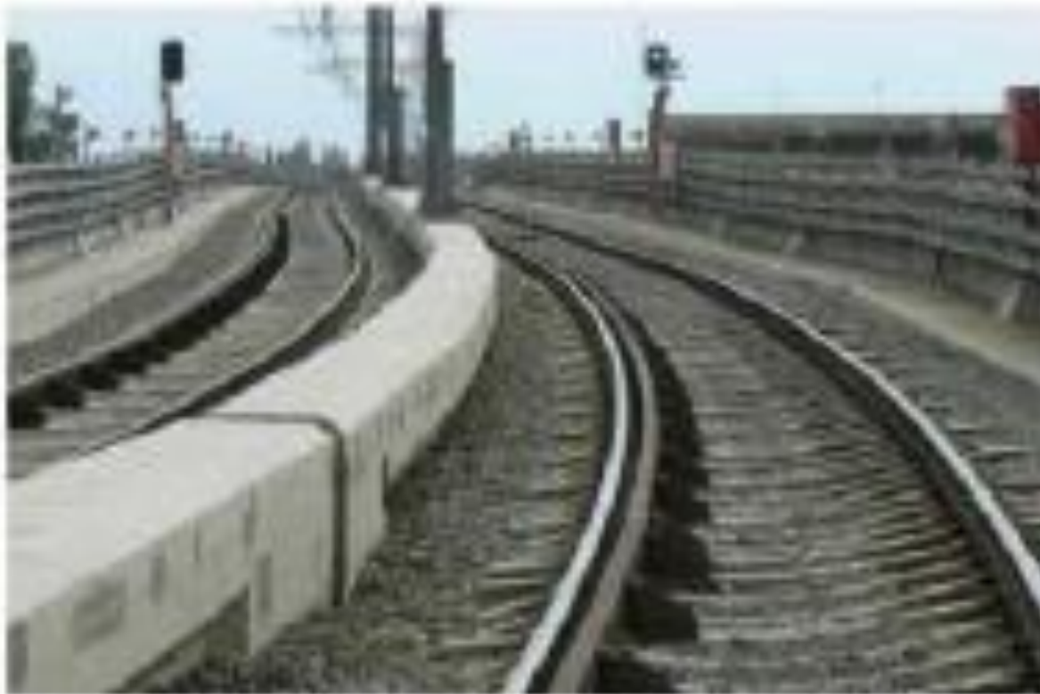
Ejemplo de defectos de nivelación en curva
