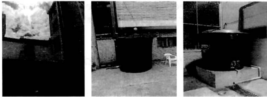
Imagen 25. Sistemas de captación de aguas lluvias B1 Chapinero, B3 Chapinero, B8 Bosa
