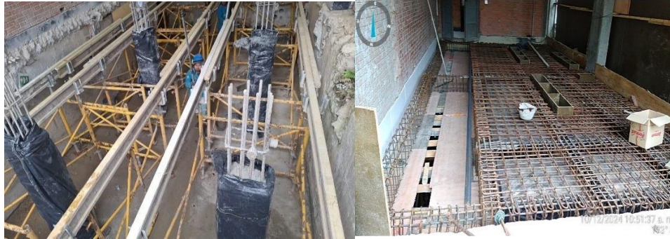
Figura 12. Frente de Obra # 8 – Subestación Eléctrica Principal.
